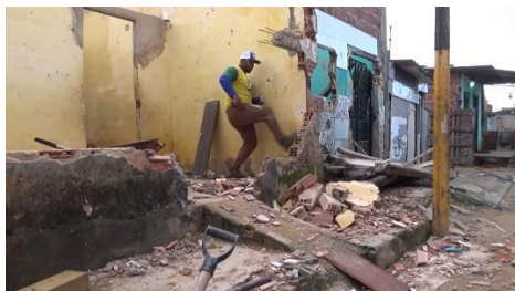
Imagem 2 – Morador retira tijolos de parede
